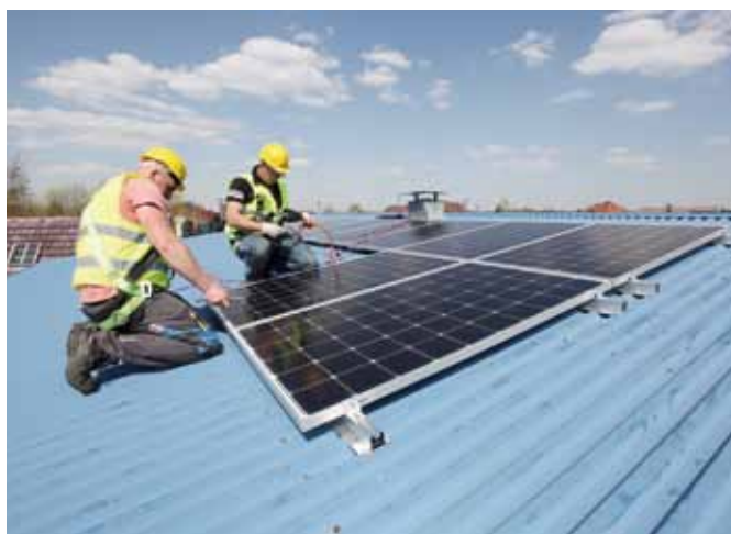
Za pośrednictwem instalacji fotowoltaicznej dochodzi do zmiany promieniowania słonecznego na energię elektryczną.
