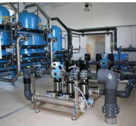
Prowod sp. z o.o. – Zmodernizowana Stacja Uzdatniania Wody w Chróścicach.
