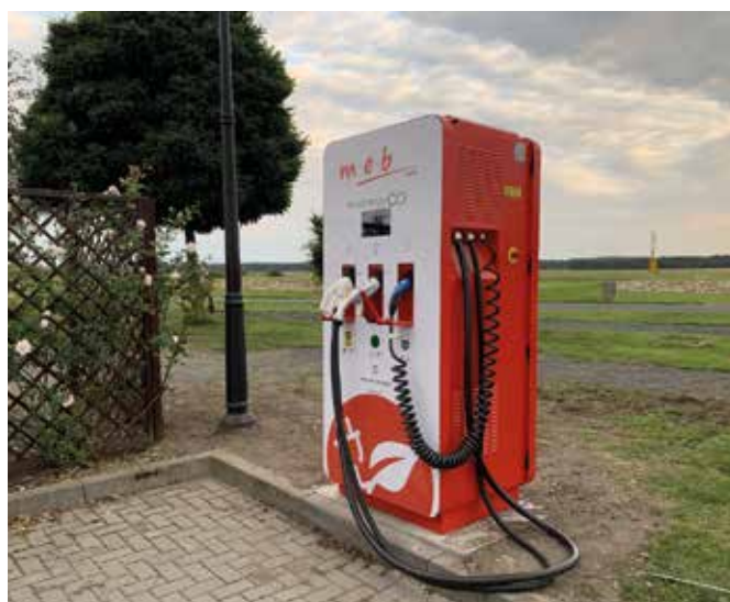
Szybka stacja ładowania pojazdów elektrycznych
