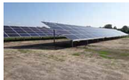
Instalacja fotowoltaiczna na SUW Chrościce
