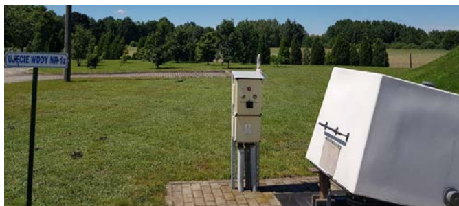
Punkt ujęcia wody
