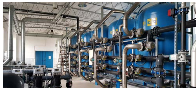
Stacja Uzdatniania Wody w Chróścicach
